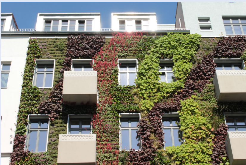
Abb. 4: Vertikales Vlies-Substrat-System auf vorgehängter, hinterlüfteter Fassade in Berlin. Begrünung u. a. mit Blaukissen, Riesensteinbrech, Storchschnabel, Christrose, Purpurglöckchen und diversen Gräsern.
